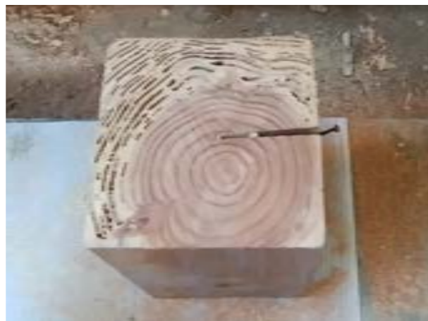
シロアリの被害を受けた柱の断面
