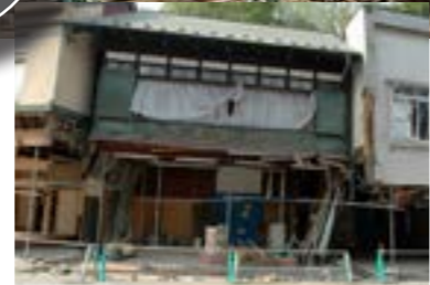
津波で1階店舗正面下屋部分が流失、内部にも大量の瓦礫が流入した
