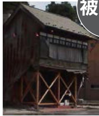
震災後に応急補強が行われた
