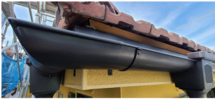
緑青促進銅板の軒樋
