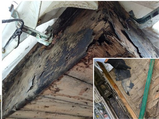
大屋根軒先腐朽
