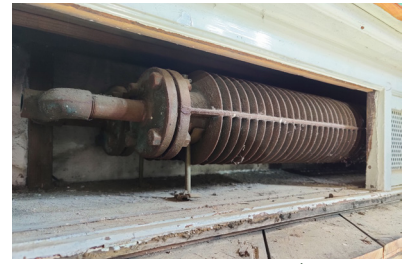
ベンチ下ラジエーター
