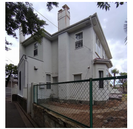
修理前南西外観
