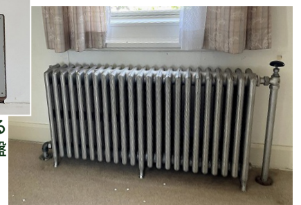
近年まで使用されていたラジエーター
